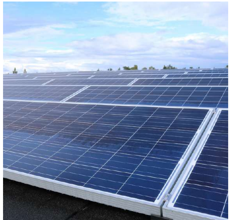
Grönare kakel med 2500 m 2 solcellsanläggning på taket
